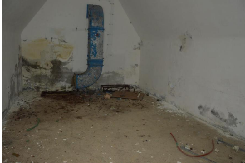
Slika 12. Derutno stanje prostorije u velikom vojnom bunkeru
