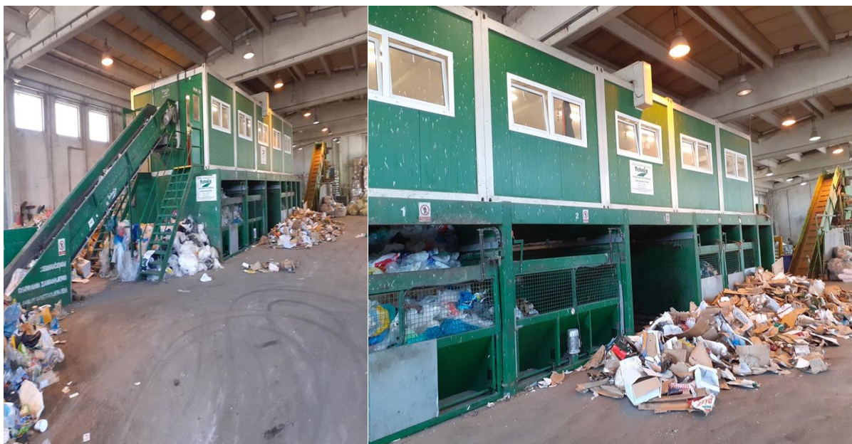
Slika 10. Otočna sortirnica na lokaciji Treskavac
